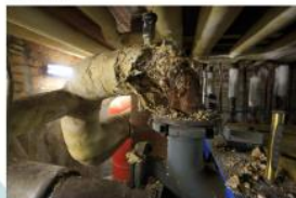
Versamingsleidingen leiden de leidingen zijn onvoldoende met isolatie en plekken. Een dergelijke toepassing kan niet-bechtgetoeder worden bewaard.
